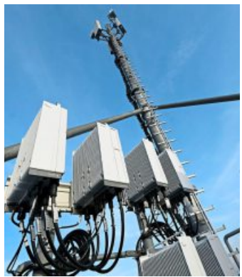
Ein 5G-Mobilfunkmast von Vodafone. Foto: dpa
